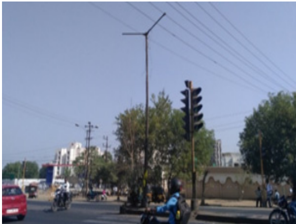
Fig. 8 Street Light not working at MIT chowk
