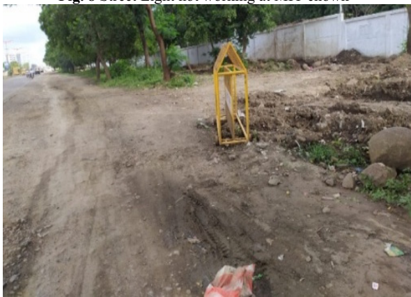
Fig. 9 Uneven Service Road at MIT chowk
